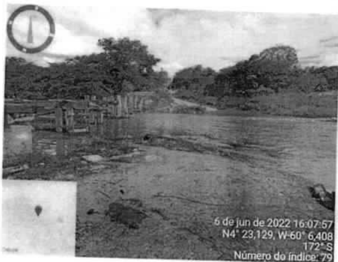
Fig. 01: Estrada de acesso a Comunidade Indígena MUTUM - Igarapé Madureza, a ponte está em construção, porém para chegar a comunidade ainda precisa passar por dentro do igarapé.
