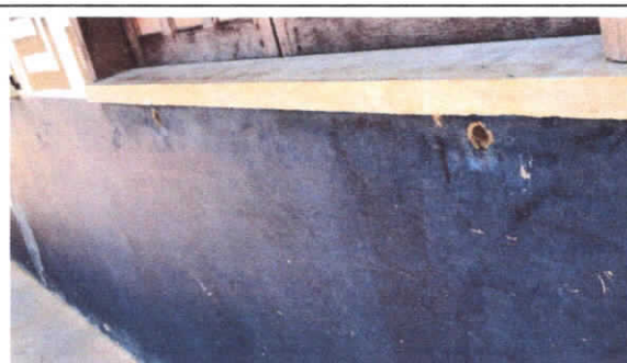
Foto 2: Fachada Lateral Leste apresenta esquadrias em madeira sem pintura, as dobradiças e ferrolhos estão degradados com isso a janelas estão com arraste e pintura descamando
