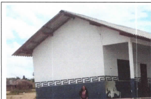
Foto 1: Parede da Fachada Lateral Oeste apresenta rachaduras e diversas telhas fissuradas causando infiltrações.
