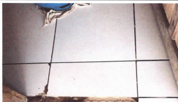
Foto 2: piso Lateral Oeste apresenta rachaduras, pintura descamando, calçada esta piso com fissuras e quebrado.
